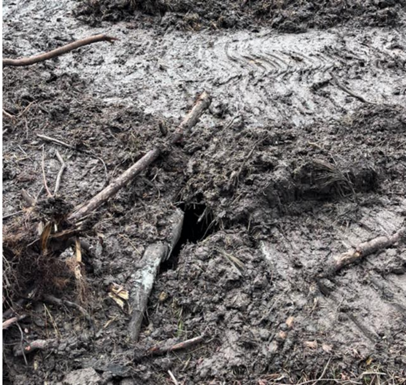
Damaged pipe Sta 3234+00
